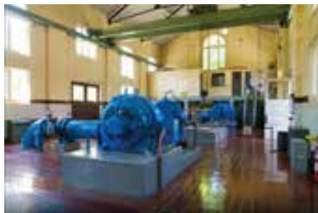
Statii de pompare apa
