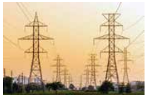
Productie de energie electrica
