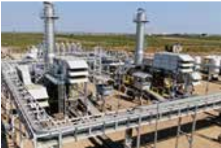
Statii de comprimare a gazului
